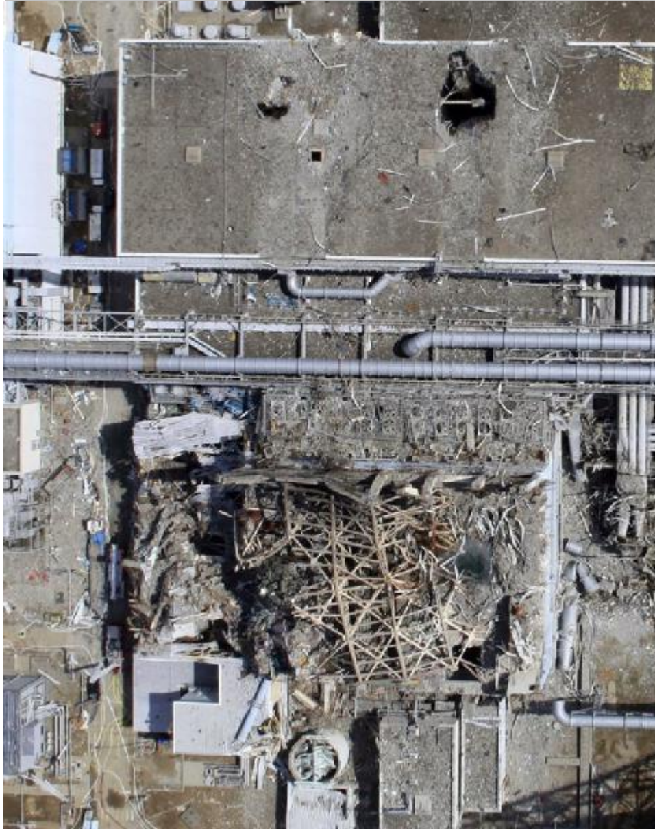
図 4-1 写真上部の福島 3 号タービン建屋には二つの大穴 撮影：2011 年 3 月 24 日
