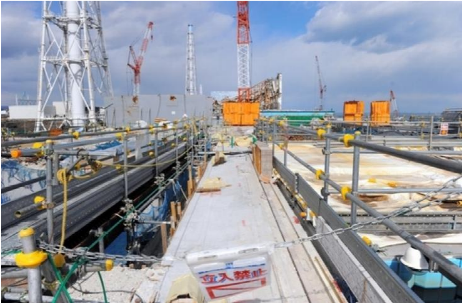
図5 福島4号5階(オペレーティングフロア)鉄骨フレーム瓦礫除去後の写真
